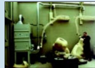
Установка с дополнительной взрывозащитой в мастерской скульптора.
